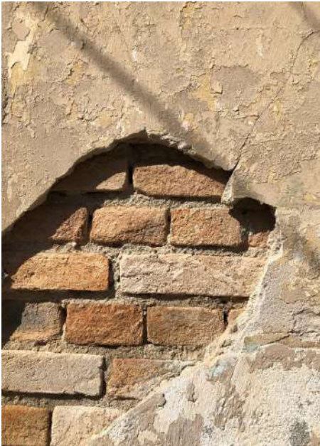
Imagem 10 - Deslocamento de argamassa em uma das fachadas das casas na Vila Economizadora (Março/2019)
